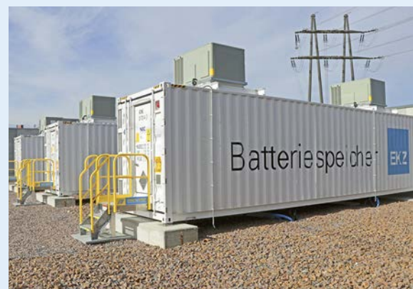
Les grands accumulateurs pourront apporter à l'avenir une contribution importante à la mise à disposition des énergies renouvelables.
