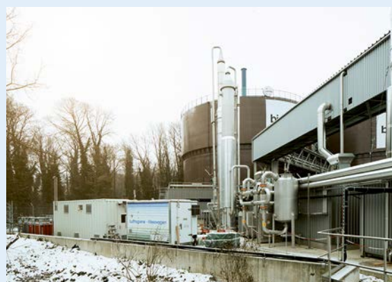
A la station d'épuration de Werdhölzli, le CO 2 est transformé en méthane avec de l'hydrogène produit à l'aide d'électricité renouvelable.
